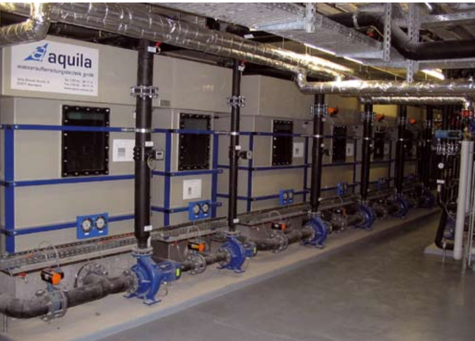
Das moderne Filtersystem im Nettebad in Osnabrück
