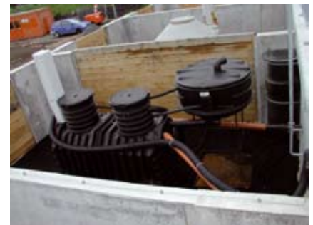
Auf dem Gelände sind Kleinkläranlagen verschiedener Technologien ausgestellt.
