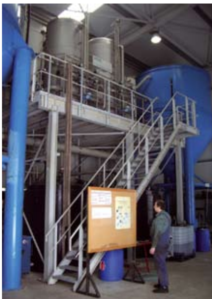
Anlage zur Wasseraufbereitung im Furnierwerk Winsen
