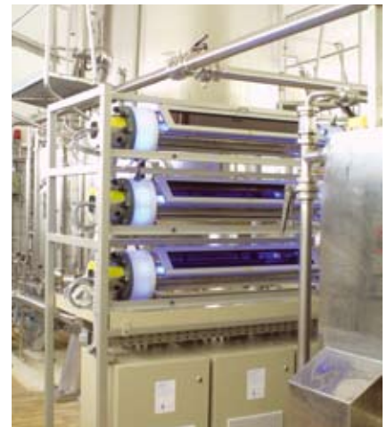
UV-Reaktor der Firma a.c.k. bei der Wirkstoffelimination aus dem Abwasser einer pharmazeutischen Mutterlaug
