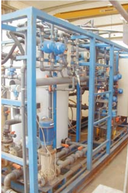
Membranbelebungsanlage zur Aufbereitung von Abwässern aus der Fruchtsaferherstellung
