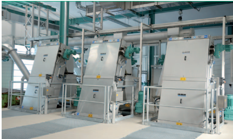
Abb. 4: Die mechanische Reinigungsstufe einer Kläranlage bei der Arbeit.
