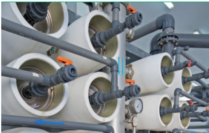
Abb. 2: Filteranlage in einer Entsalzungsanlage. Foto: Paul Vinten (sst)
